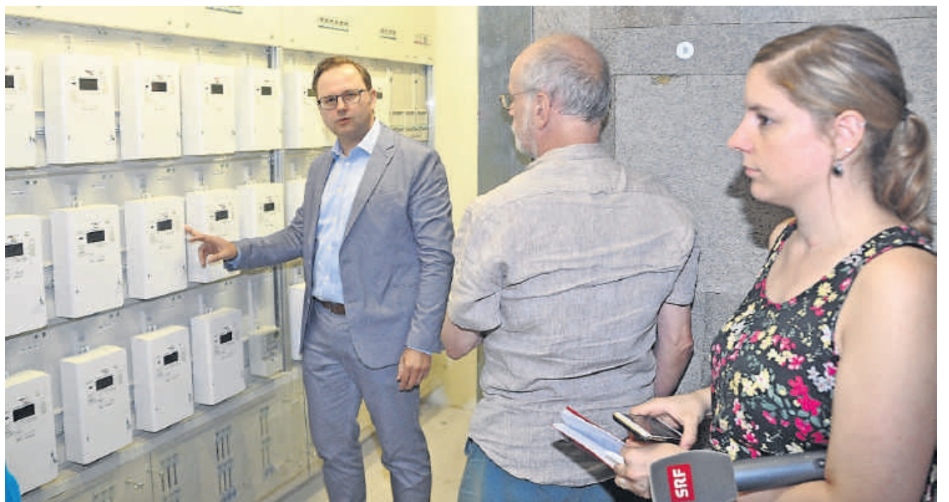
Michael Jastrob, Leiter Abrechnung der zur EKZ gehörenden Enplus (Mitte), erklärt die Zähler im Technikraum der Sentmatt-Überbauung. (Bild Werner Schneiter)
